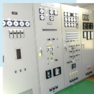
監視制御装置
